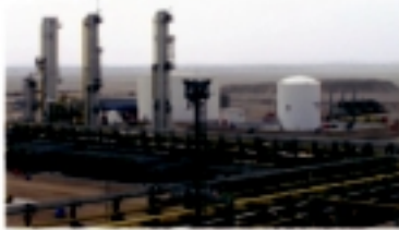
محطة تنقية مياه شكل (١٥)
